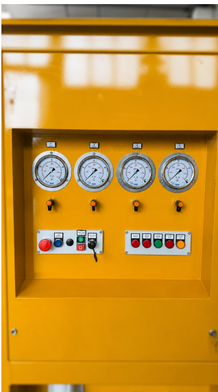
Foto 04 - Dettaglio comandi Adatta per comunicare controllo, monitoraggio e sicurezza operativa.
